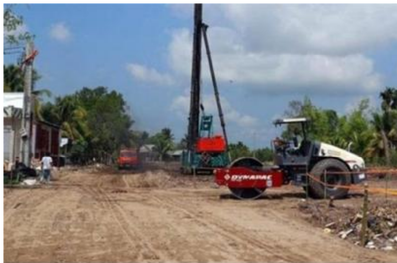
Nhiều đoạn thuộc DA cao tốc Cần Thơ - Cà Mau ngừng thi công do không có cát đắp nền
