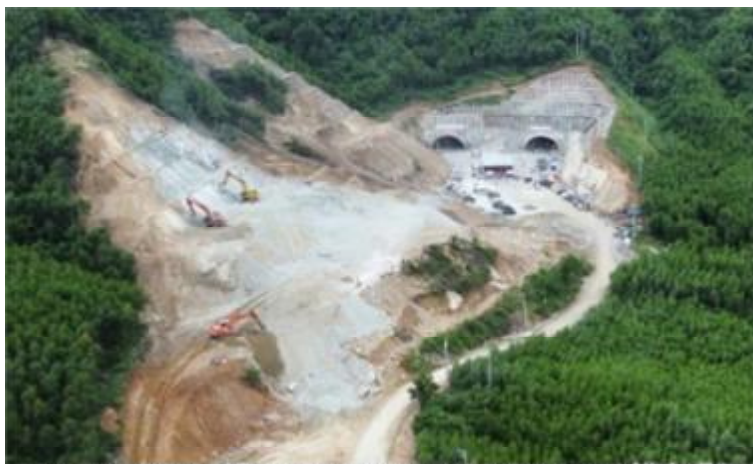
Việc áp dụng phương pháp đào hầm mới giúp việc thông hầm số 2 dài 698m thuộc gói thầu XL02) DA cao tốc Quảng Ngãi-Hoài Nhơn được rút ngắn 4 tháng so với kế hoạch ban đầu.
