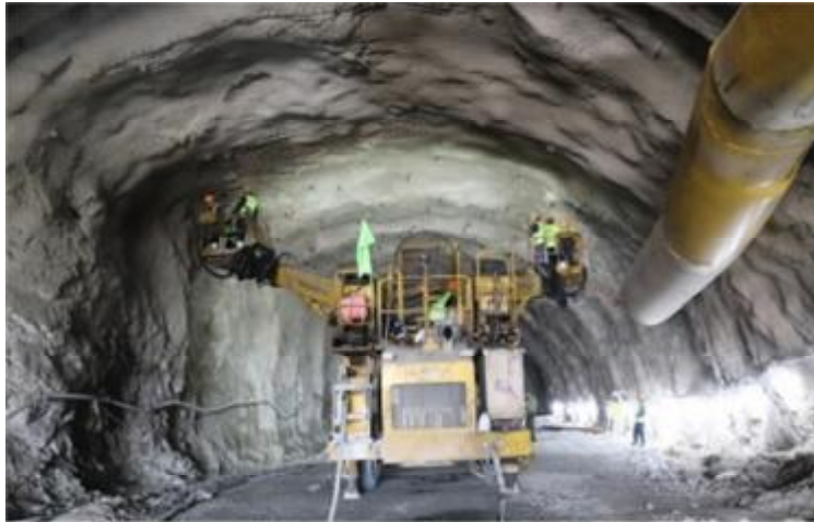
Với phương pháp đào hầm "hệ Đèo Cả", đòi hỏi phải sử dụng các thiết bị chuyên dụng, hiện đại.
