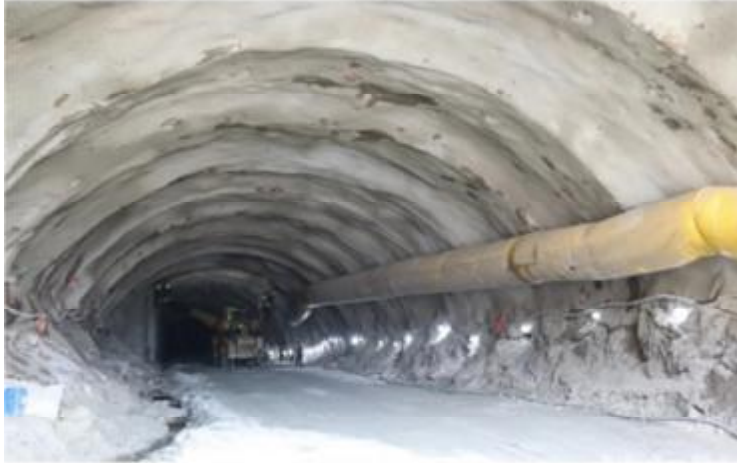
Tập đoàn Đèo Cả tăng số lượng mũi thi công từ 4 mũi thông thường thành 6 mũi, giúp tăng hiệu quả sử dụng máy móc thiết bị, giảm chi phí nhân công, máy móc
