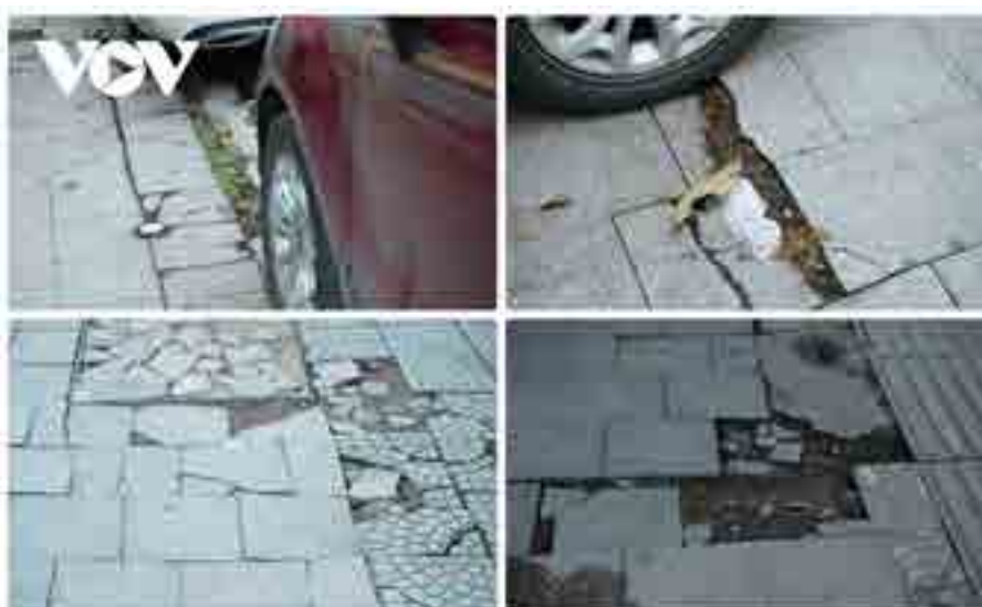
Hình 7. Vỉa hè phố Lê Trọng Tấn, đá lát tự nhiên “vĩnh cửu” và gạch terrazzo bị xuống cấp, bung, sụt lún và vỡ nát
