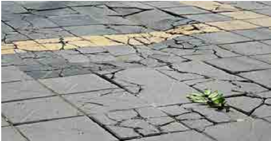
Hình 1. Vỉa hè đường Nguyễn Chí Thanh được lát gạch giả đá, nhưng sau một thời gian sử dụng đều trong tình trạng vỡ vụn.
