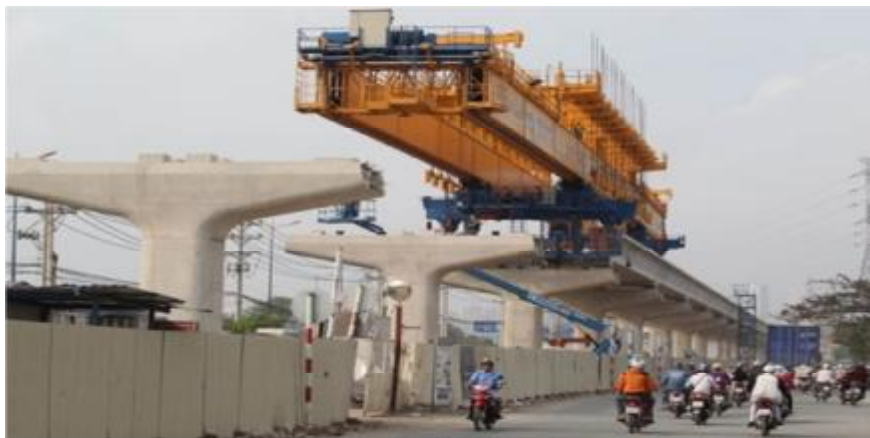
Công nghệ BIM được ứng dụng trong thực hiện Dự án tuyến metro 1: Bến Thành - Suối Tiên
